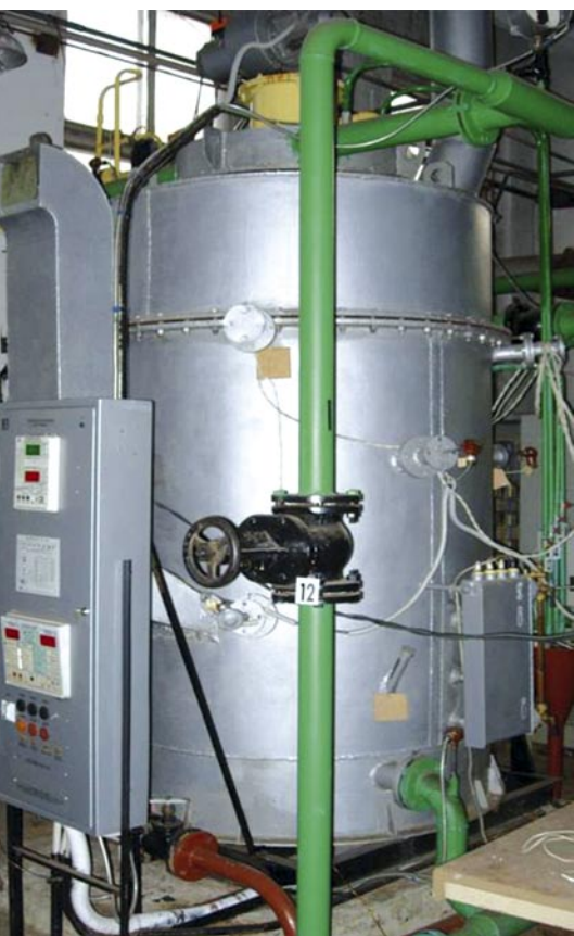
Рис. 1. Общий вид теплогенератора КАОМ -1,0
