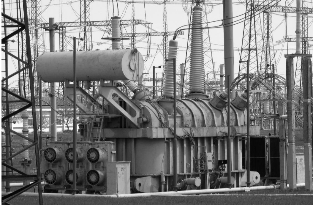
Рис. 3.1. Силовий автотрансформатор 750/330 кВ
