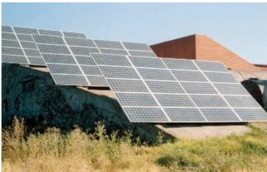
Рис. 1.11. Фотоелектрична система енергопостачання комплексу на о. Зміїний потужністю 10 кВт
