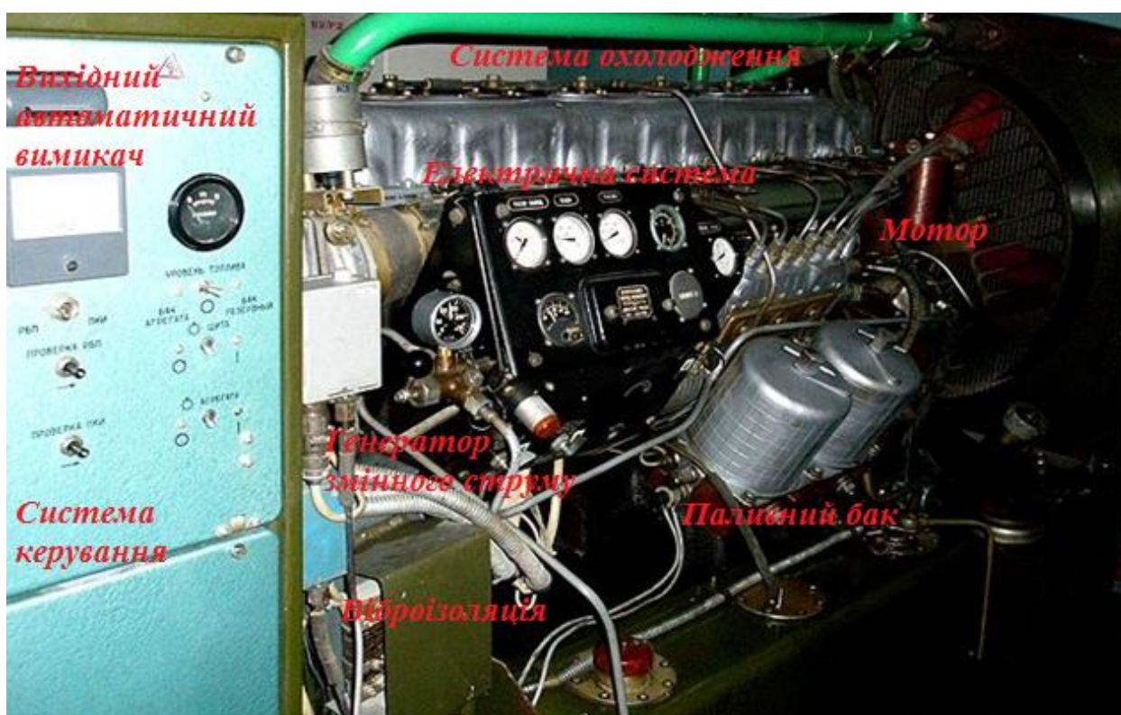
Рис. 8.1. Стационарна дизельна електростанція
